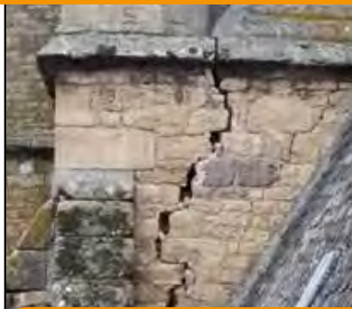
D'importantes fissures sur les murs porteurs du clocher.
